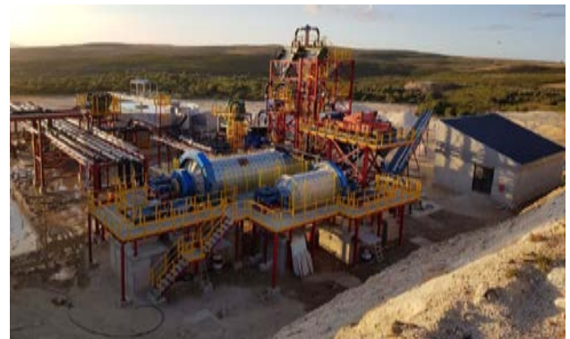
Fig 5. Área de clasificación y molienda de la planta de procesamiento de la mina de Penouta.
