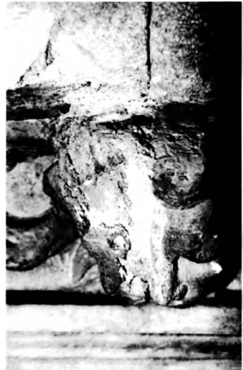
FOTO 2.- Detalle deterioro cornisas.
